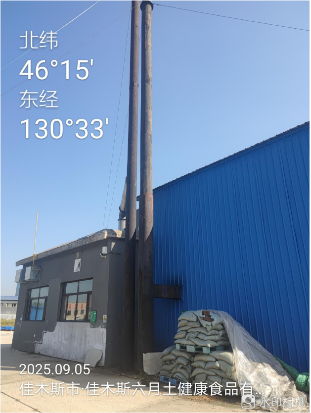
备用燃气锅炉烟囱
