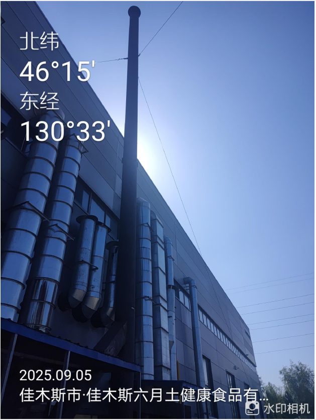
生产车间排气筒
