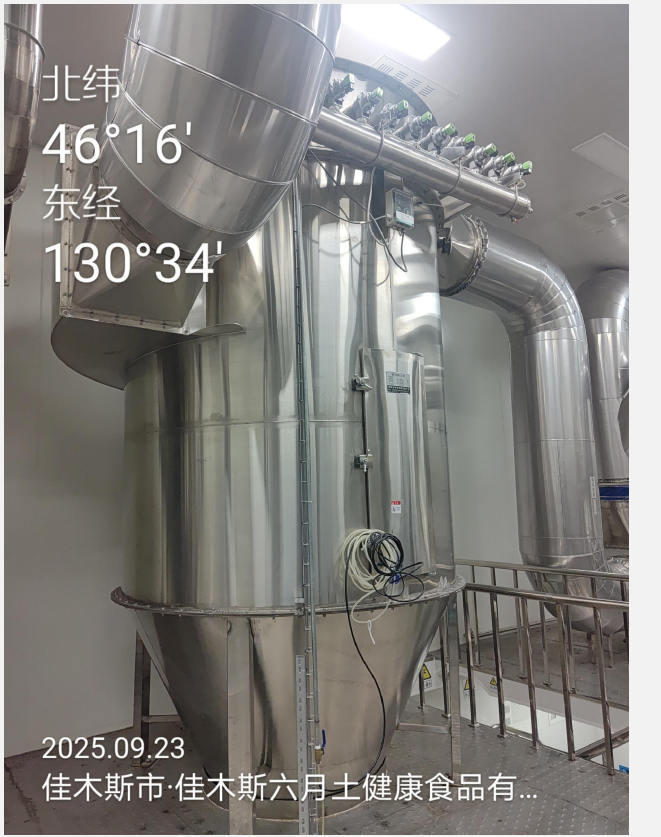
生产车间脉冲布袋除尘器
